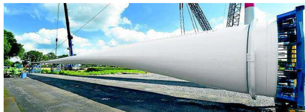
Jedes Rotorblatt wird mit je 72 Schrauben an der Nabe der Windenergieanlage festgemacht.
