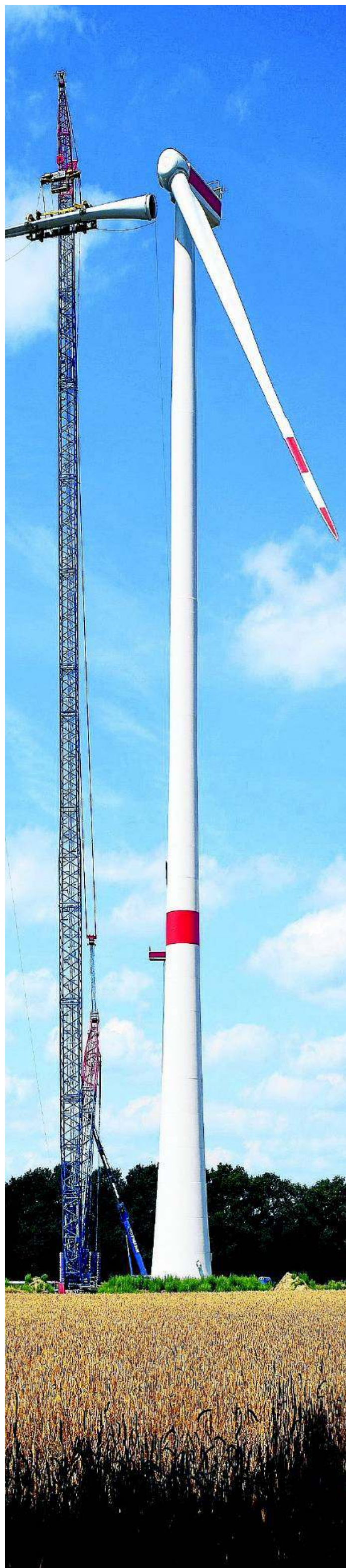
Das Wetter passt, kaum Wind – ideale Voraussetzungen für die Montage der drei Rotorblätter am gestrigen Freitag in St. Arnold. Jedes Blatt ist 65 Meter lang und wird aus Sicherheitsgründen an der Transporthalterung des Krans fest verankert.
