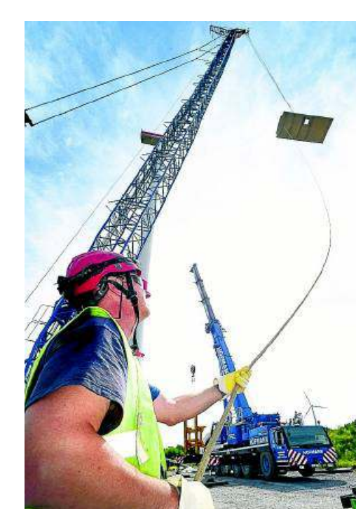
Mit Seilen wird das Dach der Gondel gesichert. Ist es zu windig, wird die Aktion abgelassen.
